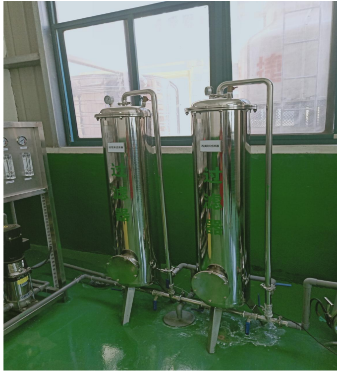
图 3-7 纯水制备设施 1
