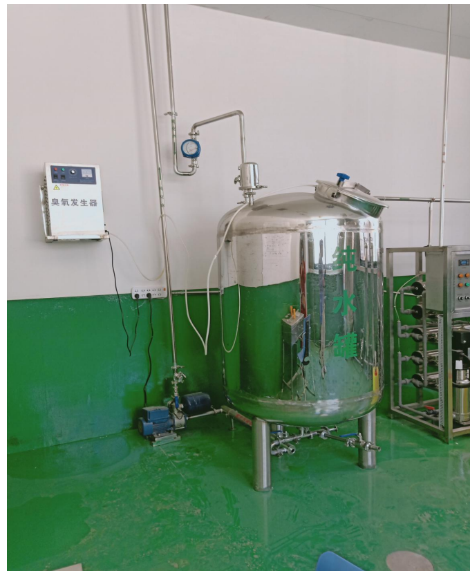
图 3-8 纯水制备设施 2
